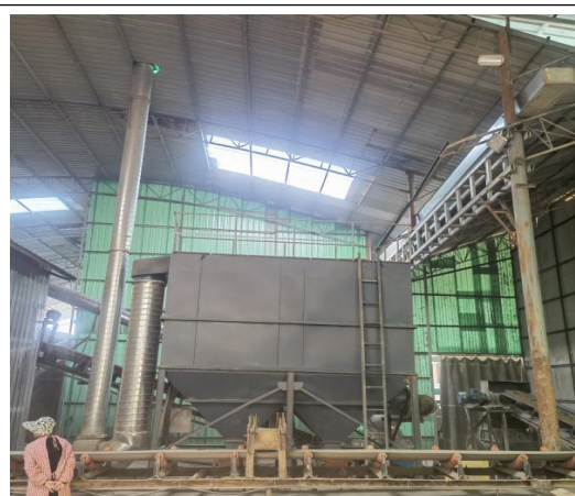
布袋除尘器及排气筒
