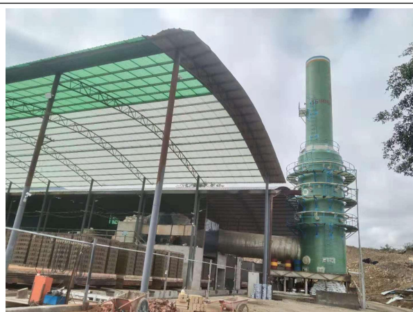
直烧窑排气筒
